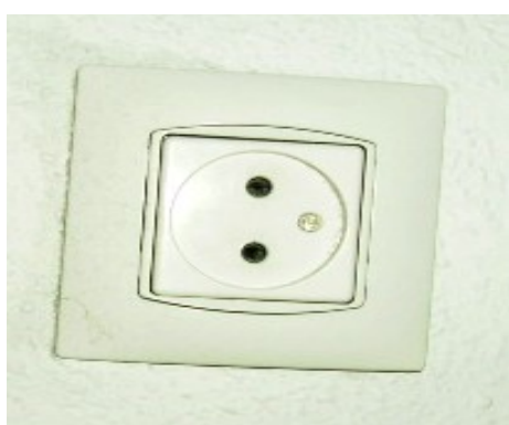
Toma de corriente sin toma de tierra
